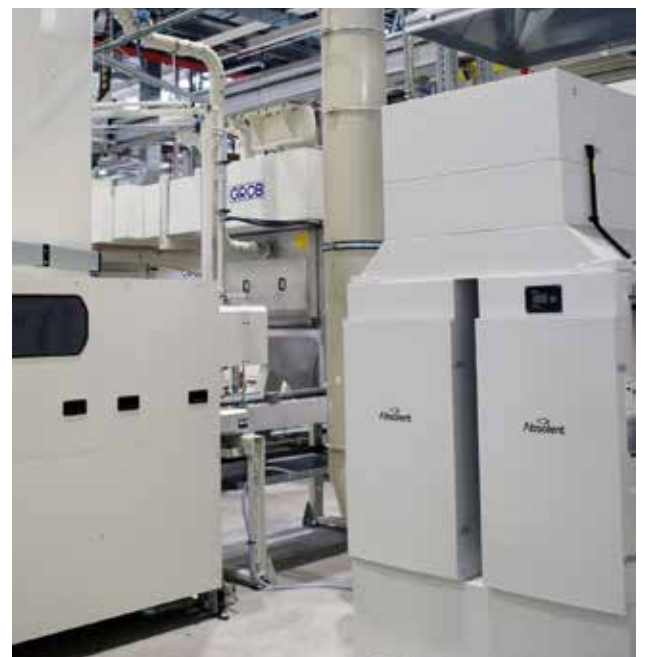
Anlage von Absolent bei MAN, Deutschland. Lösung: A-mist80TF (eine Filtereinheit für jede Maschine)
